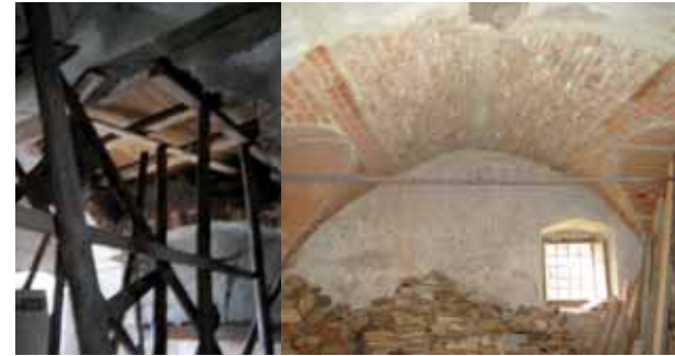
Bild links: Gewölbeneinsturz Bild rechts: Sanierteres Gewölbe
